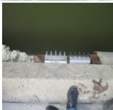
Slika 8. Vidljivo curenje nakon puknuća duktilnog cjevovoda i cijev nakon sanacije (veljača 2017. Petrijevi na mostu DC 34)
