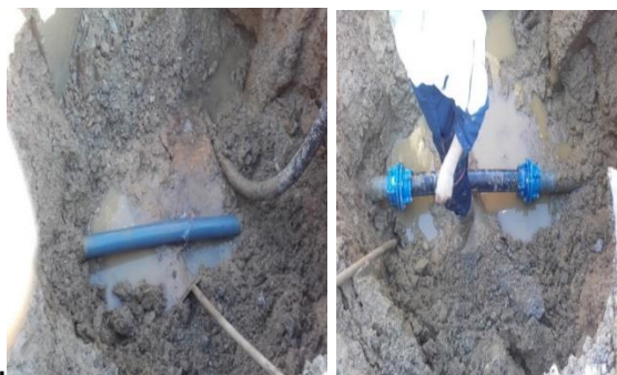
Slika 6. Lom PVC cijevi i curenje u Ulici I. L. Ribara u Valpovu (travanj 2015.) te stanje nakon sanacije
