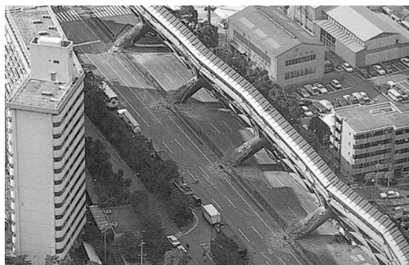
Slika 3. Posljedice potresa iz 1995. na glavnoj arteriji grada Kobe (Gazetas et al., 2006)
