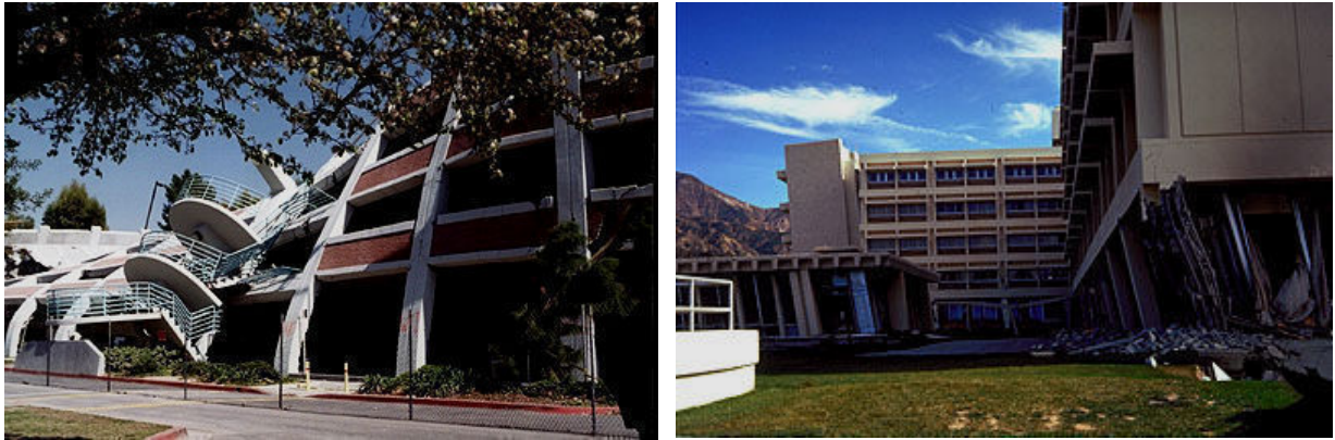
Slika 1. Oštećenja građevina uslijed djelovanja potresa
