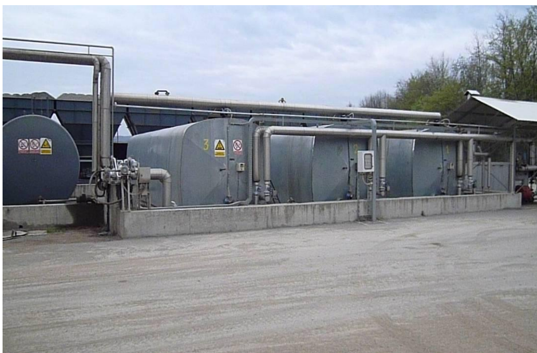
Slika 96. Spremnici za bitumen – A.P. Orahovica (Gravia d.o.o.)
