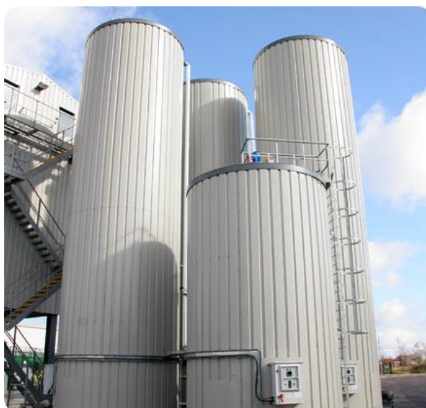
Slika 28. Vertikalni spremnici za bitumen [130]
