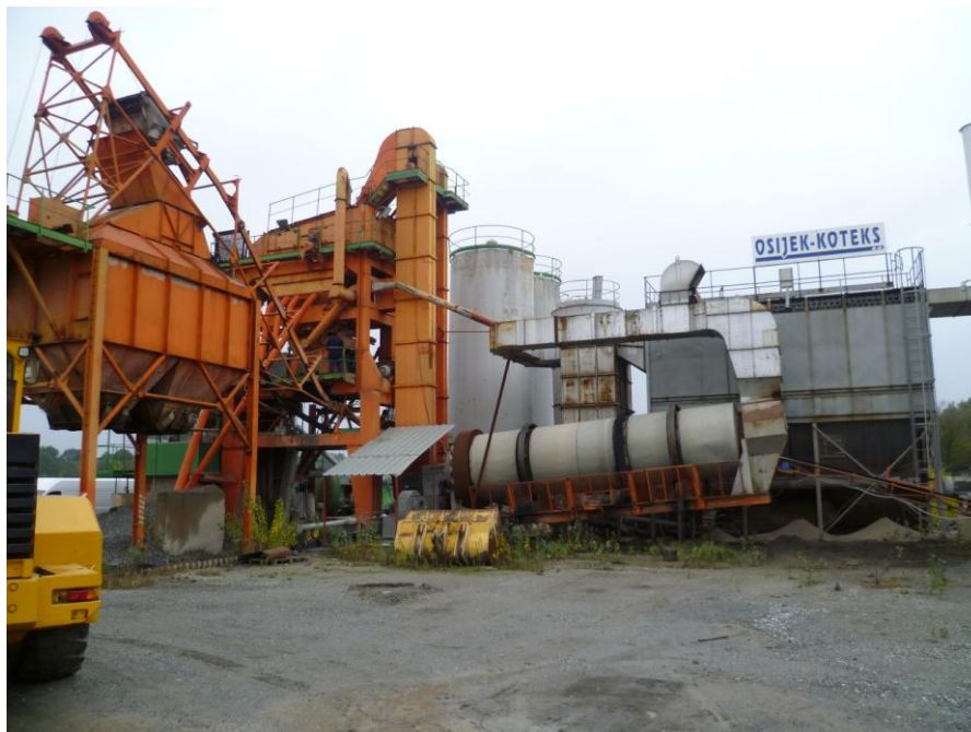
Slika 31. Asfaltno postrojenje u Lužanima
