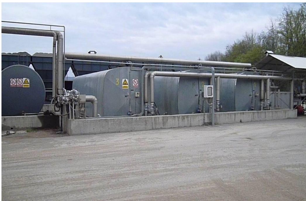
Slika 96. Spremnici za bitumen – A.P. Orahovica (Gravia d.o.o.)
