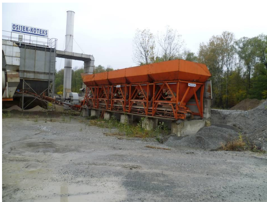
Slika 77. Hladni spremnici za frakcije kamenog agregata u Lužanima (preddozatori)
