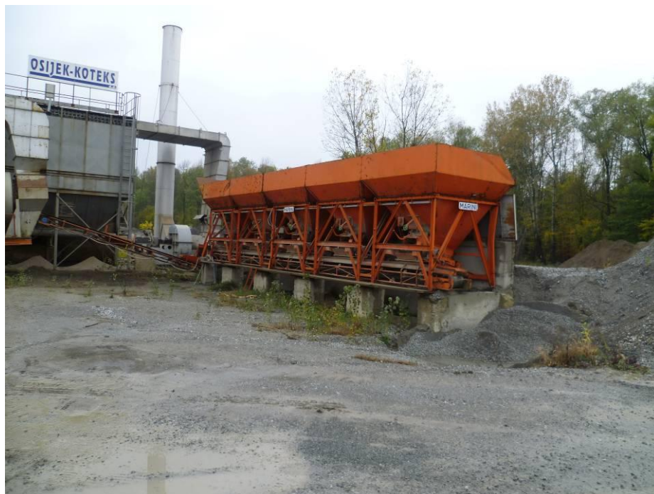
Slika 77. Hladni spremnici za frakcije kamenog agregata u Lužanima (predozatori)
