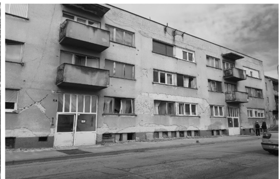
b) zgrada u Petrinji snimljena nakon potresa 28.12. 2020.
