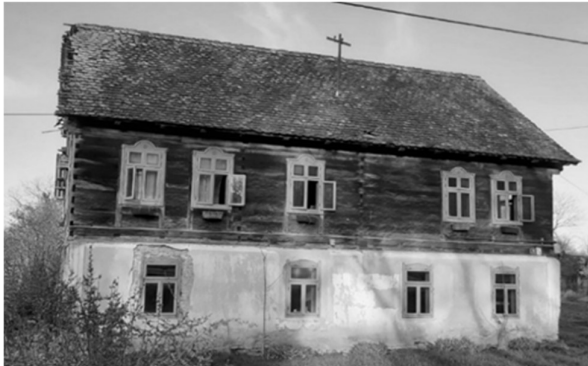
a) drvena zgrada na Banovini snimljena nakon potresa 28. 12. 2020.
