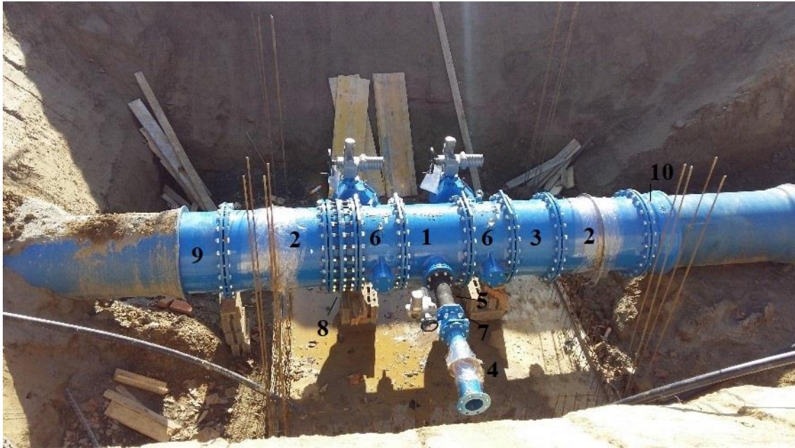
Slika 6.6 Čvorište s postavljenim fazonskim komadima, armaturama i izbetoniranom donjom pločom i pripremljenom armaturom za zidove okna
