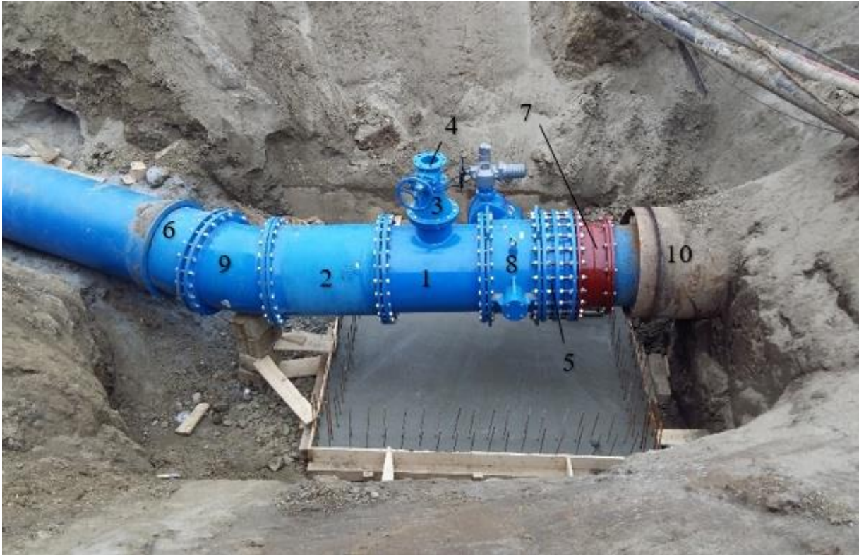
Slika 6.3 Čvorište magistralnog cjevovoda DN 800 s koljenom i zaštitnom čeličnom cijevi izvan okna (1. T komad DN 800/300, 2. FF komad DN 800 L= 1000 mm, 3. FFR komad DN 300/150, 4. EV zasun DN 150, 5. MDK komad DN 800, 6. F komad DN 800, 7. E komad ST system (prirubnička spojnica / redukcija za duktil DN 800 / DN 700), 8. Leptirasti zatvarač s el. motornim DN 800, 9. FFK komad DN 800 22\frac{1}{2} , 10. Zaštitna čelična cijev s distancerima) [10]
