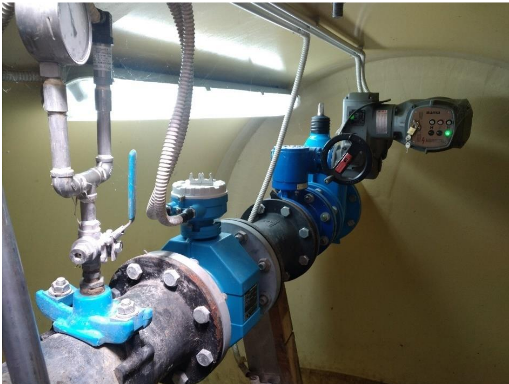
Slika 6.17 Unutrašnjost PEHD okna u koje su smješteni mjerači tlaka i protoka spojeni na nadzorno upravljački sustav vodoopskrbe, okno se nalazi neposredno uz izvorište vode [11]
