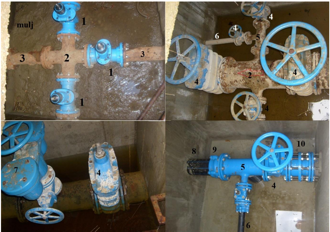
Slika 6.15 Primjer vodovodnih čvorišta
