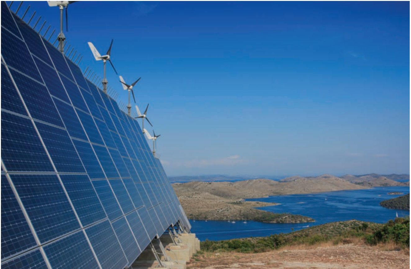
Slika 5. Fotonaponska elektrana, jadranska Hrvatska, autor: Romulić & Stojčić multimedia studio
