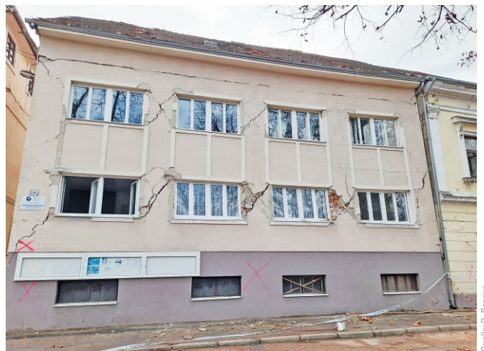
Bild 10 Typisches Schadensbild für Mauerwerksgebäude: diagonale Schubrisse in den relativ schlanken Mauerwerks Pfeilern und Mauerwerksriegeln (Schadensgrad 2–3) Typical damage patterns in masonry structures: diagonal shear cracks in relative slender piers and spandrels (damage grade 2–3)
