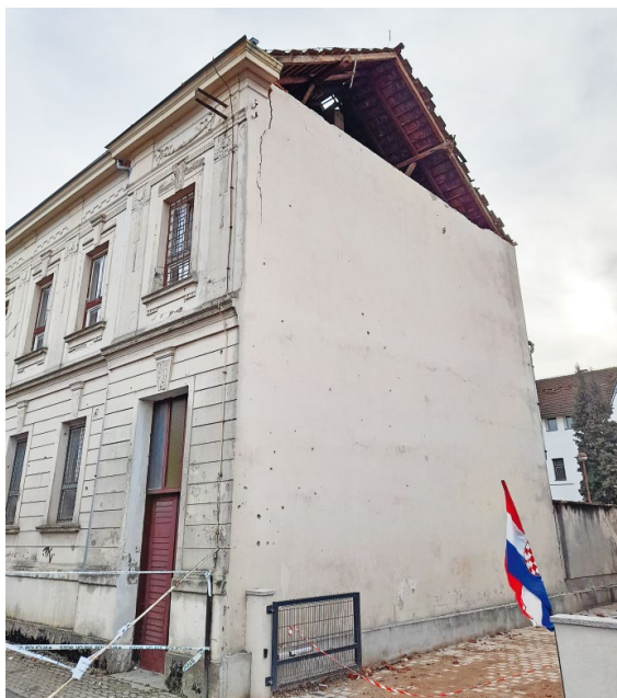
Bild 9 Beispiel für Versagen der Giebelwände infolge fehlender Rückverankerung mit dem Dachstuhl (Schadensgrad 3–4) Example of gable wall collapse due to the lack of tieback with the roof truss (damage grade 3–4)
