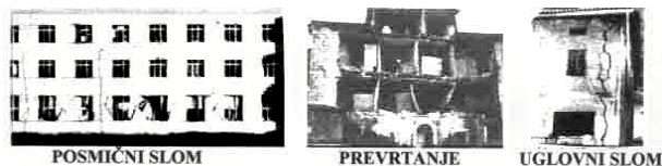
Slika 1. Karakteristična oštećenja kamenom zidanim zgradama u potresu
