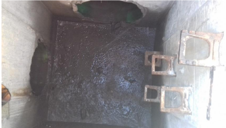
Slika 5.6. Separator Južna obilaznica (18.05.2017)
