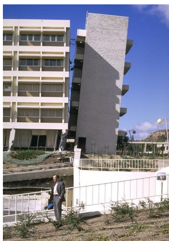
Slika 4. Zgrade bolničkog kompleksa Olive View nakon potresa San Fernando 1971: nagnuće zgrade zbog sloma u temeljnom tlu (Steinbrugge, 1971)
