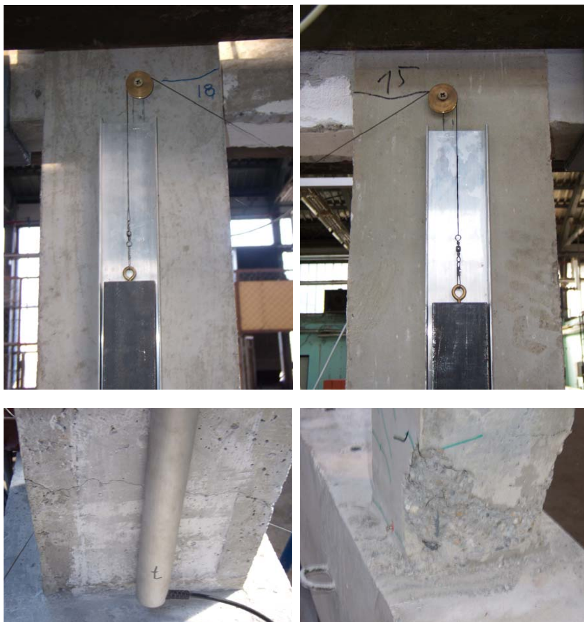
Slika 4.42 Prikaz pukotina na MODELU 10
