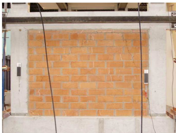
a) Prve značajne pukotine u ispunu
