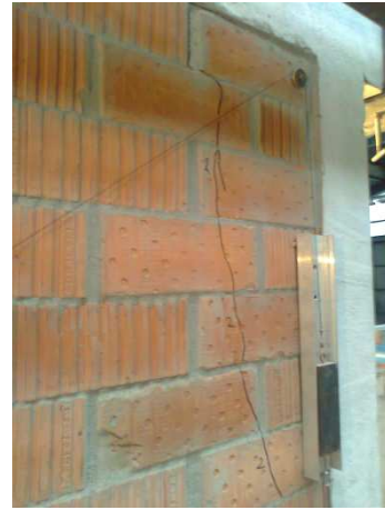
b) Prva značajna pukotina pri negativnom smjeru opterećenja
