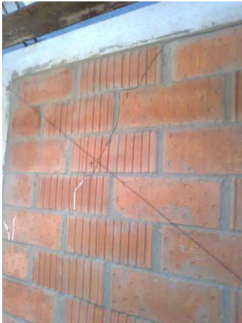
a) Prva značajna pukotina pri pozitivnom smjeru opterećenja
