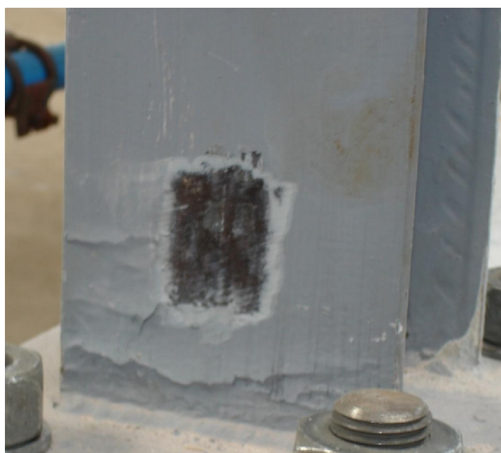
Slika 4.68 – Plastifikacija čeličnog stupa
