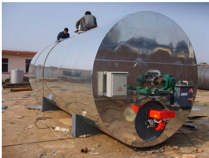
Slika 27. Spremnik za bitumen [129]
