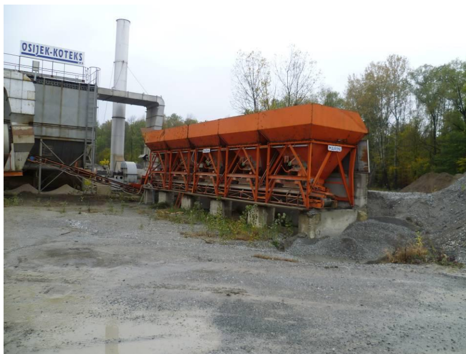
Slika 77. Hladni spremnici za frakcije kamenog agregata u Lužanima (preddozatori)
