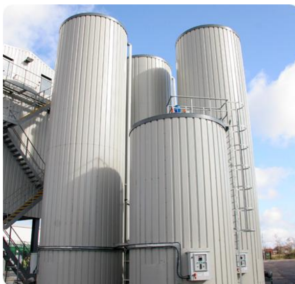
Slika 28. Vertikalni spremnici za bitumen [130]
