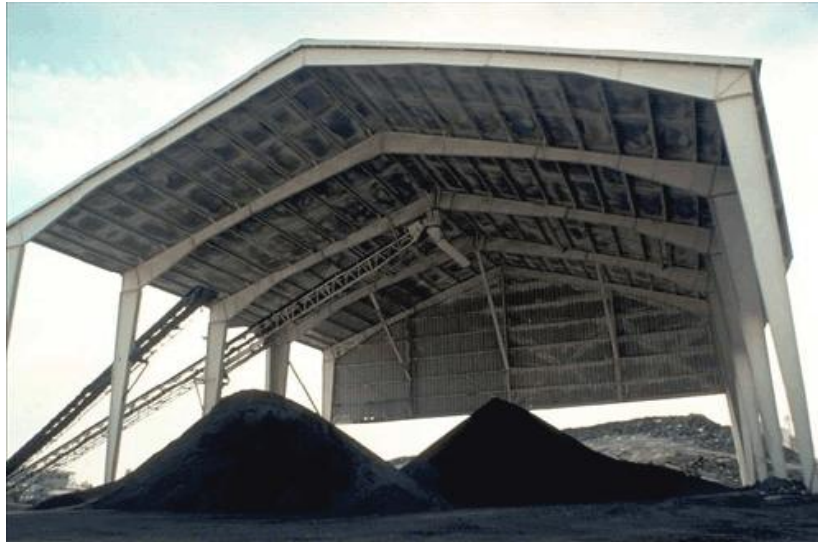
Slika 11. Natkrivena deponija recikliranog asfalta [99]
