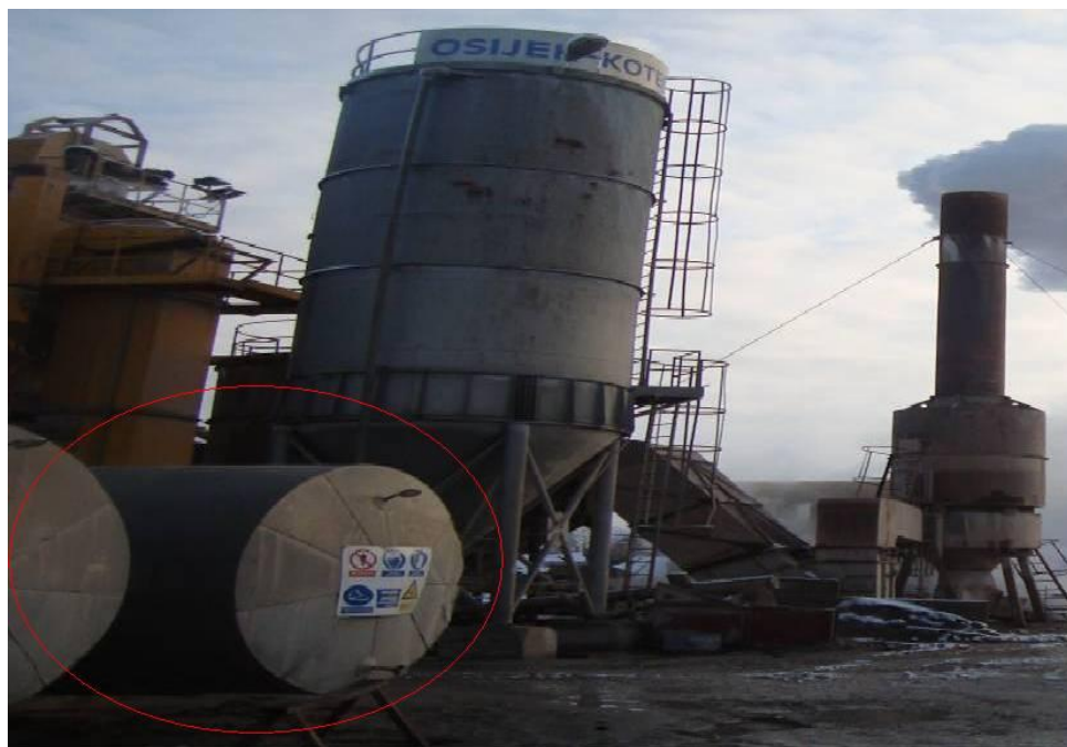
Slika 76. Spremnici za uskladištenje bitumena u Nemetinu
