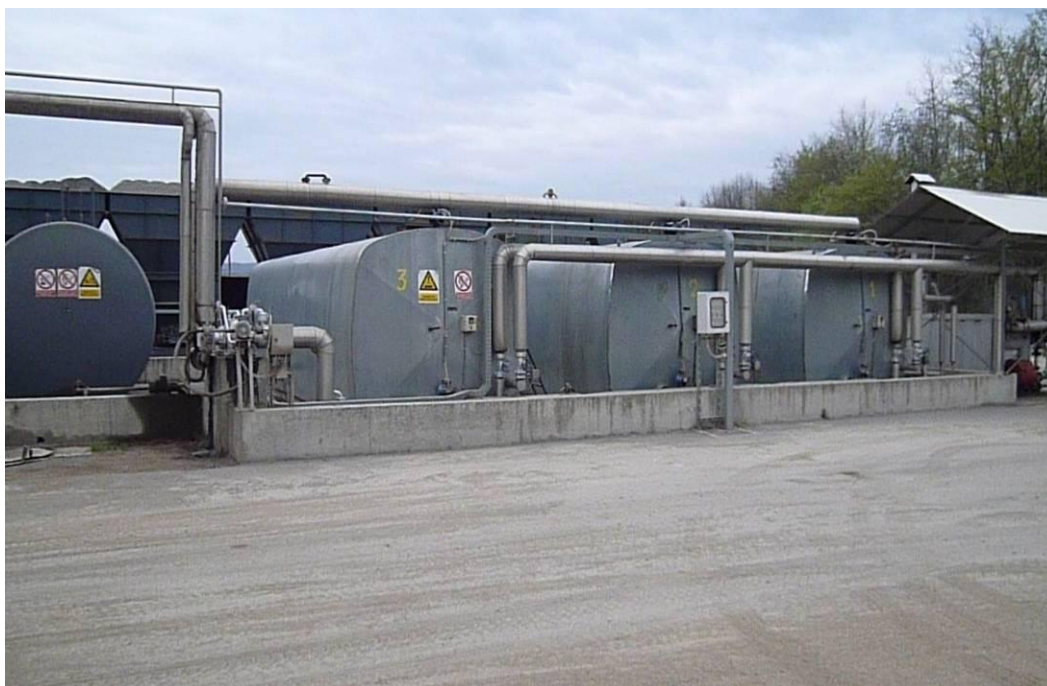
Slika 96. Spremnici za bitumen – A.P. Orahovica (Gravia d.o.o.)
