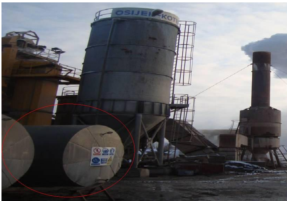
Slika 76. Spremnici za uskladišteni bitumen u Nemetinu
