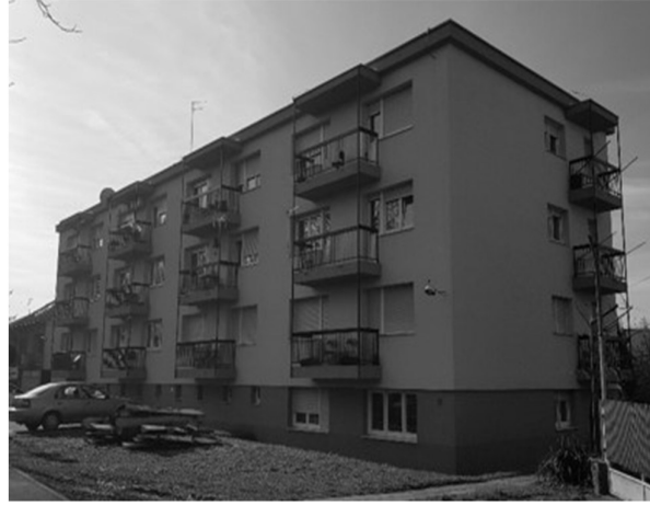
b) zgrada u Petrinji izgrađena 2015. snimljena nakon potresa 28.12. 2020.
