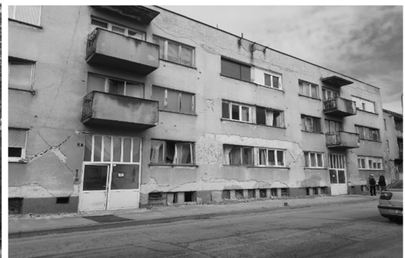
b) zgrada u Petrinji snimljena nakon potresa 28.12. 2020.
