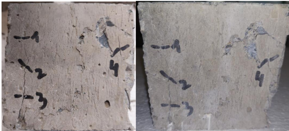
Slika 6.68. Mješavina M1 nakon smrzavanja i odmrzavanja (lijevo – prije samocijeljenja, desno - nakon samocijeljenja)
