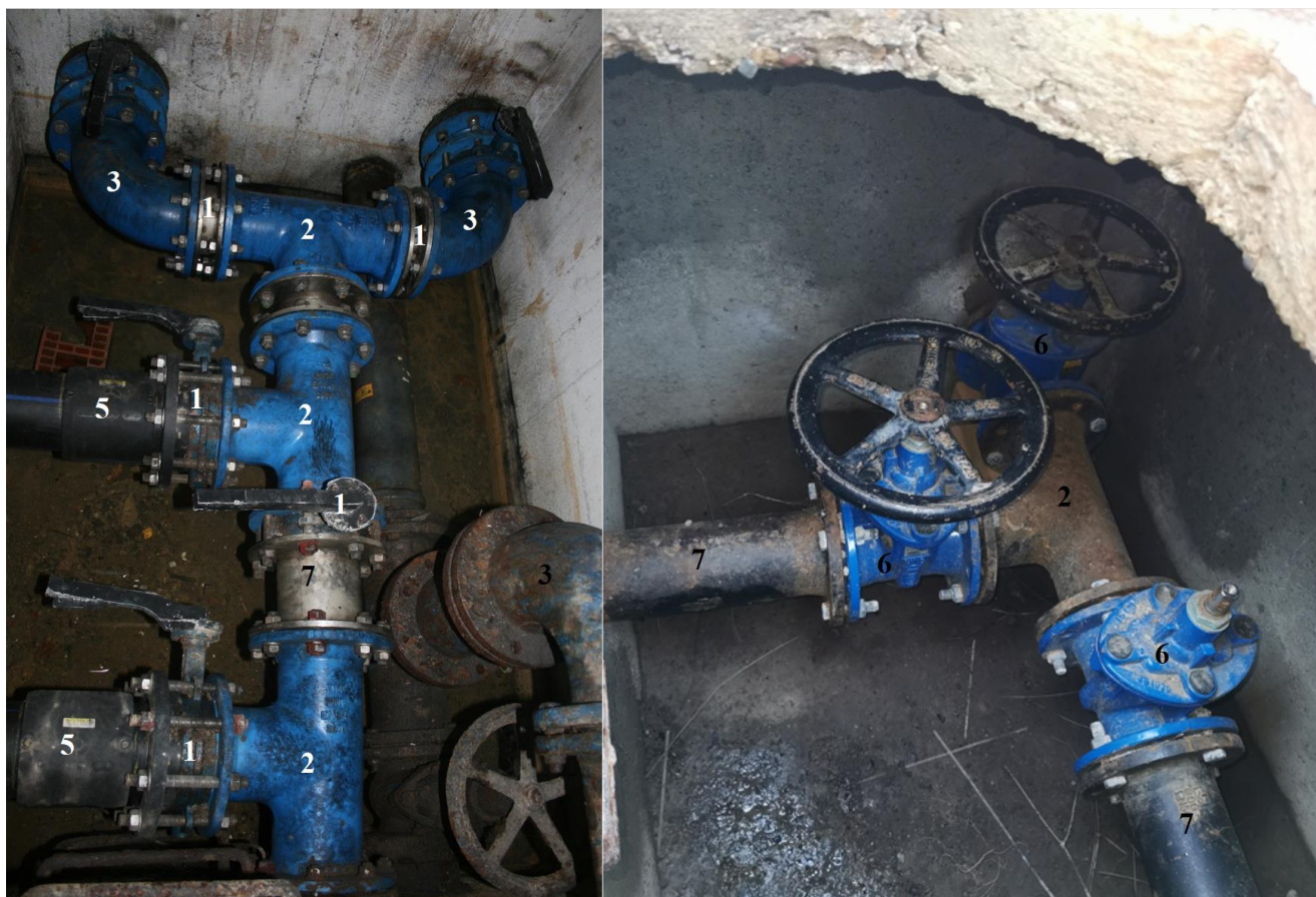
Slika 6.13 Primjer vodovodnih čvorišta
