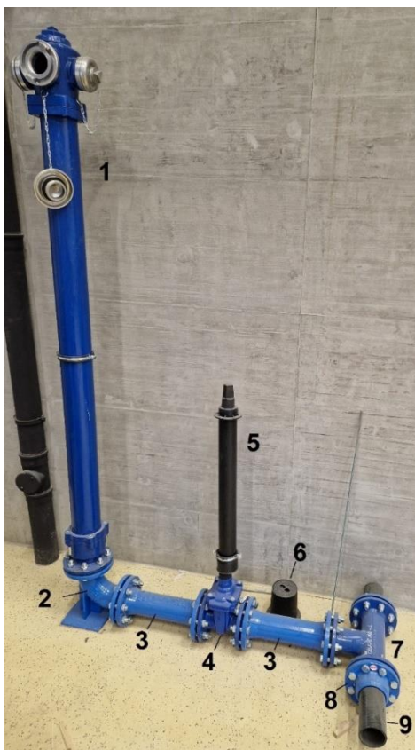
Slika 6.1 Primjer izvedbe hidrantske mreže od glavnog voda PEHD DN 110 sa spojnim komadima i armaturom, do nadzemnog hidranta DN 100
