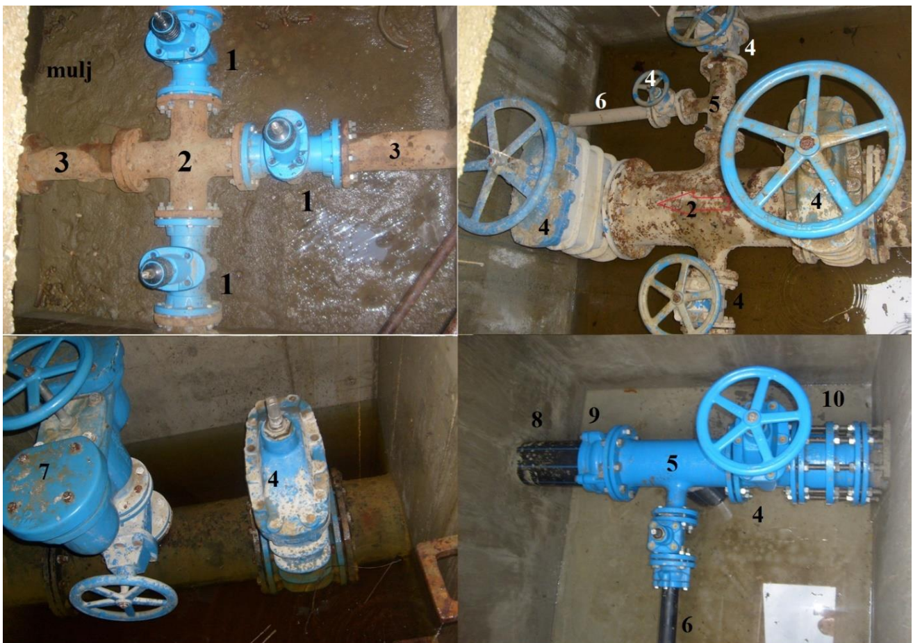
Slika 6.15 Primjer vodovodnih čvorišta
