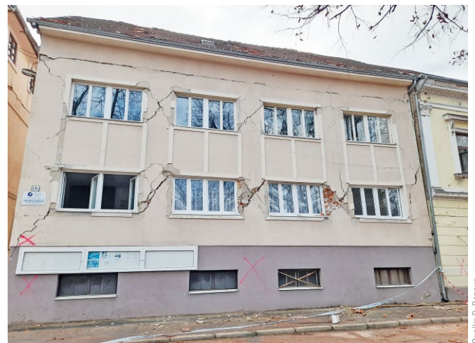
Bild 10 Typisches Schadensbild für Mauerwerksgebäude: diagonale Schubrisse in den relativ schlanken Mauerwerks Pfeilern und Mauerwerksriegeln (Schadensgrad 2–3) Typical damage patterns in masonry structures: diagonal shear cracks in relative slender piers and spandrels (damage grade 2–3)
