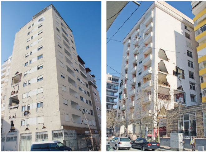
Bild 6 Beispiele zum dominierenden Schadensbild an den inspizierten Gebäuden in Durrës (Albanien) Examples of the dominant damage patterns of the inspected buildings in Durrës (Albania)
