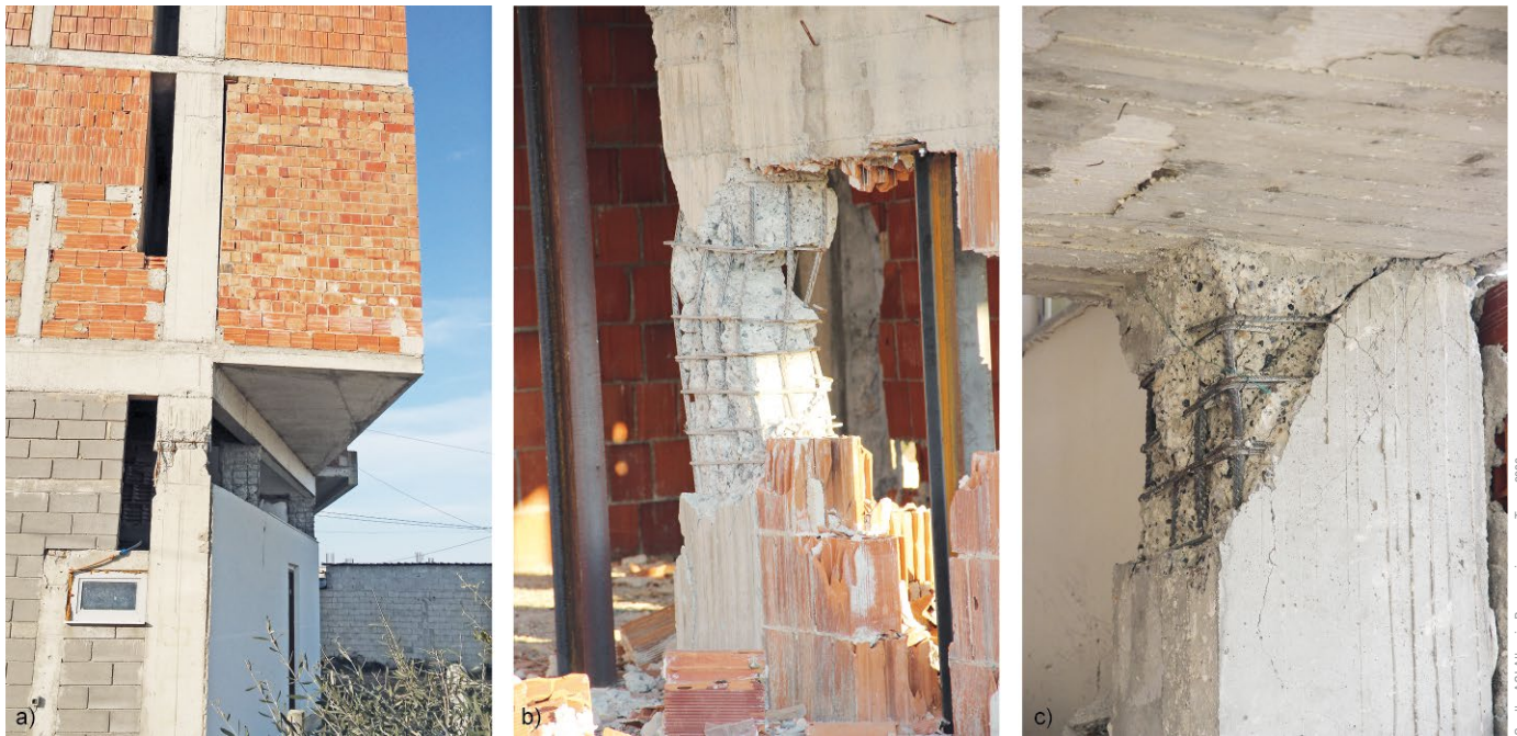
Bild 5 Beobachtete Schäden an Stahlbetonstützen und -riegeln unterschiedlicher Schwere in Durrës (Albanien): a), b) schwerer Schaden (Ausknicken der Längsbewehrung) – Schadensgrad 4, c) mittlerer Schaden (Abplatzen Betondeckung) – Schadensgrad 3 Observed damage cases of different strength at RC elements in Durrës (Albania)
