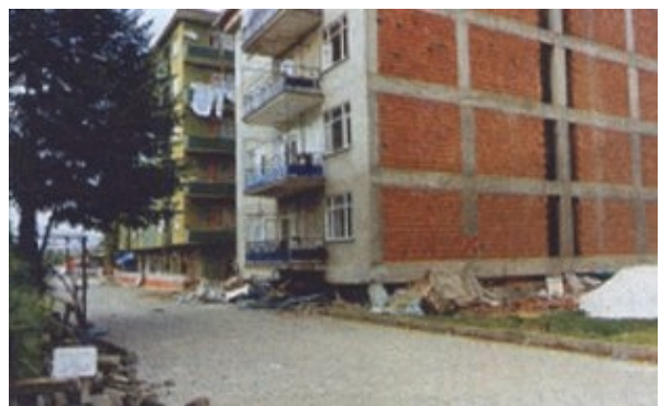
Slika 8. Oštećenje zgrade zbog mekog prizemlja http://www.its.caltech.edu/~ayhan/EQ/Golcuk.html
