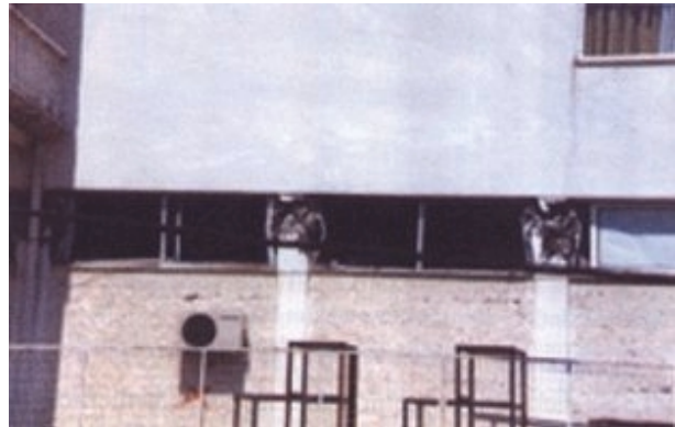
Slika 7. Oštećenje kratkih stupova http://www.eeri.org/Reconn/Greece1099/Greece1099-3.html
