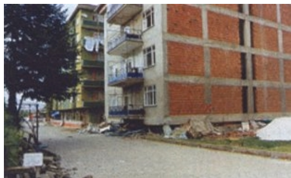
Slika 8. Oštećenje zgrade zbog mekog prizemlja http://www.its.caltech.edu/~ayhan/EQ/Golcuk.html
