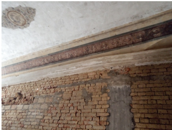
Slika 4.2 Primjer nekompatibilnog spoja morta i opeke u konstrukciji
