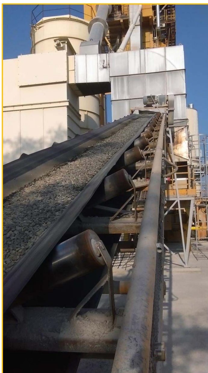
Slika 7-20: Kosa transportna traka na asfaltnoj bazi
