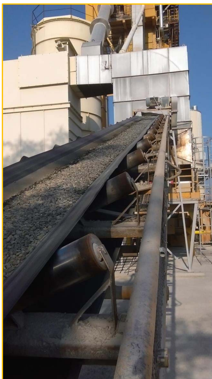
Slika 7-20: Kosa transportna traka na asfaltnoj bazi
