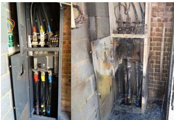
Slika 1. Posljedice električnog luka na električnim instalacijama [1]
