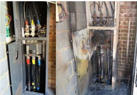
Slika 1. Posljedice električnog luka na električnim instalacijama [1]
