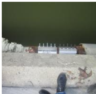
Slika 8. Vidljivo curenje nakon puknuća duktilnog cjevovoda i cijev nakon sanacije (veljača 2017. Petrijevi na mostu DC 34)
