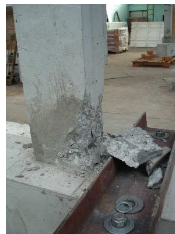
d) Oštećenje desnog stupa ispitnog uzorka
