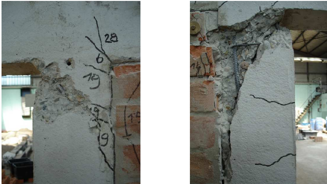
Slika 6.41 Prikaz posmičnih pukotina stupova okvira ispitnog uzorka O1_cpm
