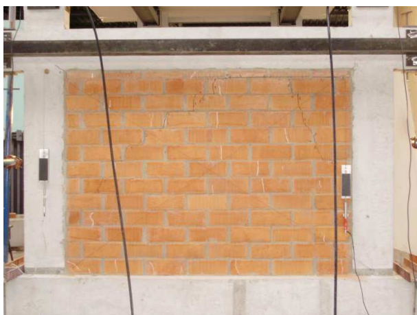
a) Prve značajne pukotine u ispunu
