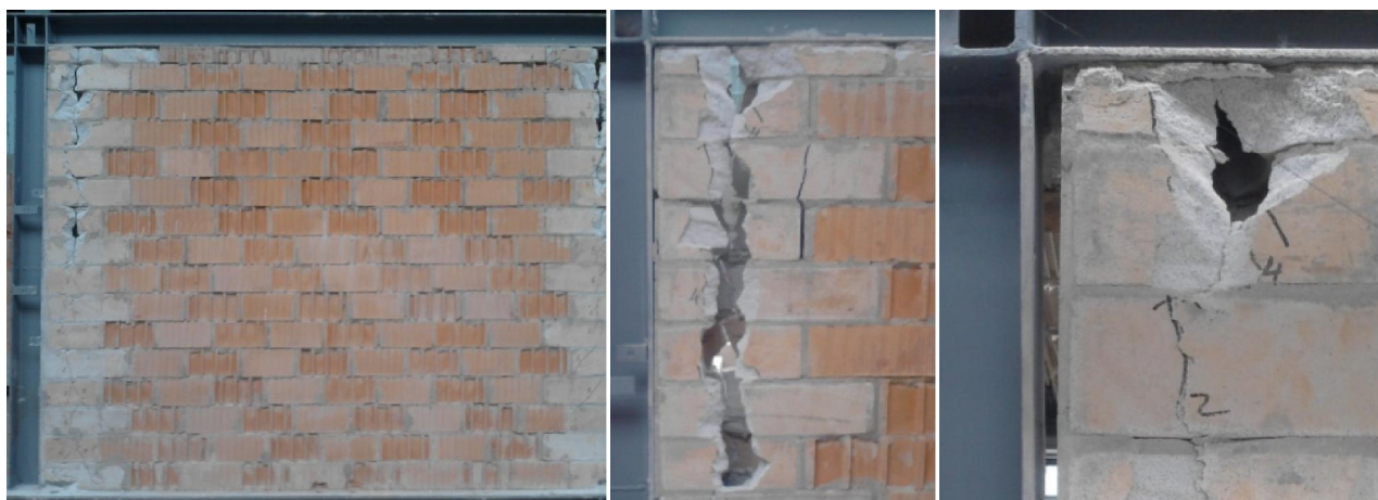
Slika 4.78 – Oštećenja okvira sa zidanim ispunom – OGY-3
