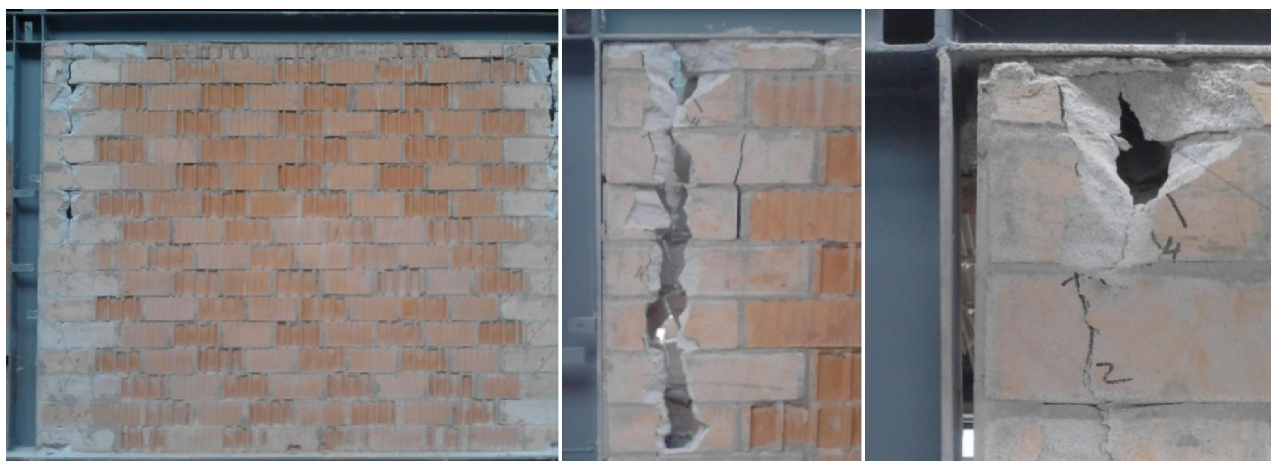
Slika 4.78 – Oštećenja okvira sa zidanim ispunom – OGY-3
