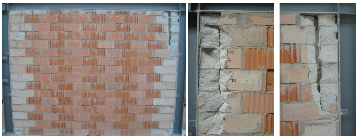
Slika 4.76 – Oštećenja okvira sa zidanim ispunom – OGY-1
