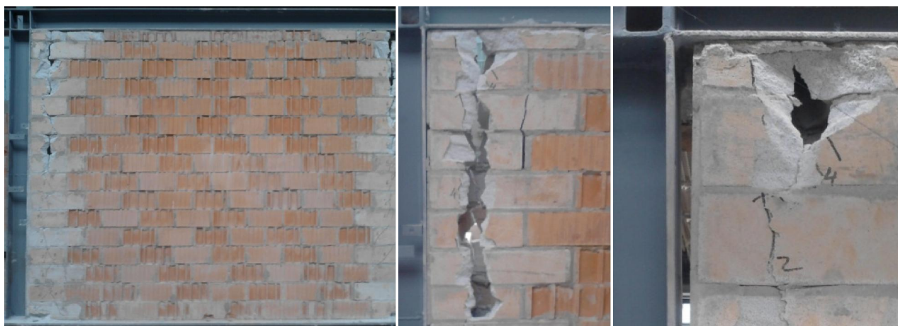
Slika 4.78 – Oštećenja okvira sa zidanim ispunom – OGY-3
