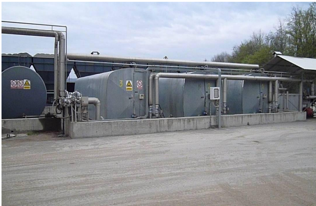
Slika 96. Spremnici za bitumen – A.P. Orahovica (Gravia d.o.o.)
