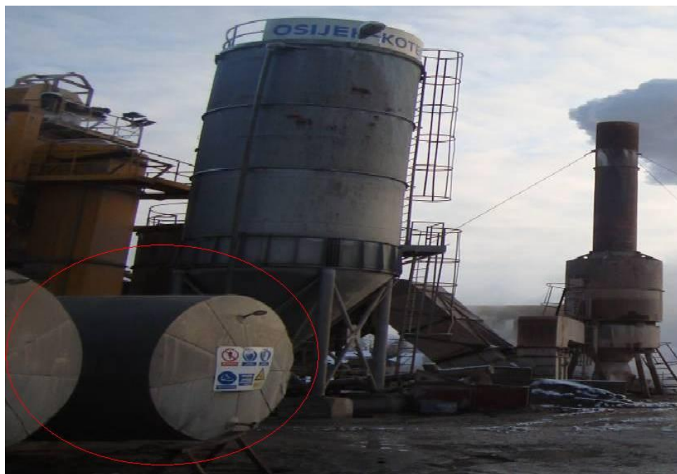
Slika 76. Spremnici za uskladišteni bitumen u Nemetinu
