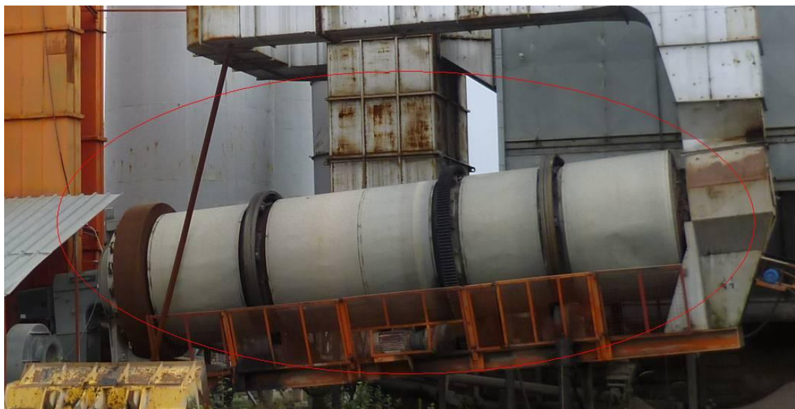
Slika 78. Rotacijski bubanj na asfaltnom postrojenju u Lužanima
