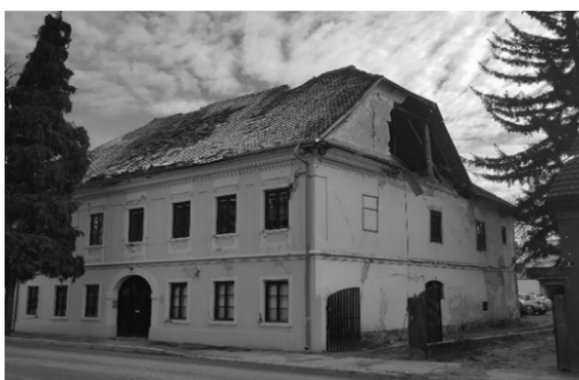
b) zgrada u Petrinji snimljena nakon potresa 28.12. 2020.
