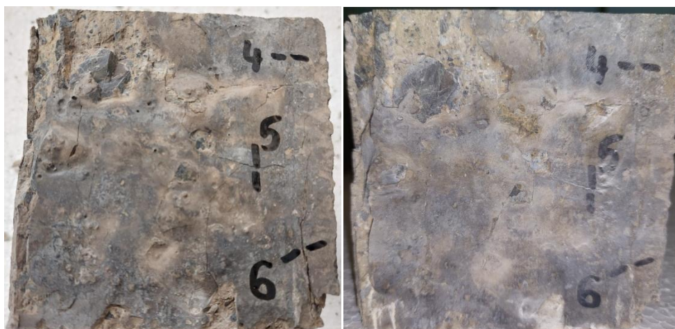
Slika 6.78. Mješavina M6 nakon smrzavanja i odmrzavanja (lijevo – prije samocijeljenja, desno - nakon samocijeljenja)
