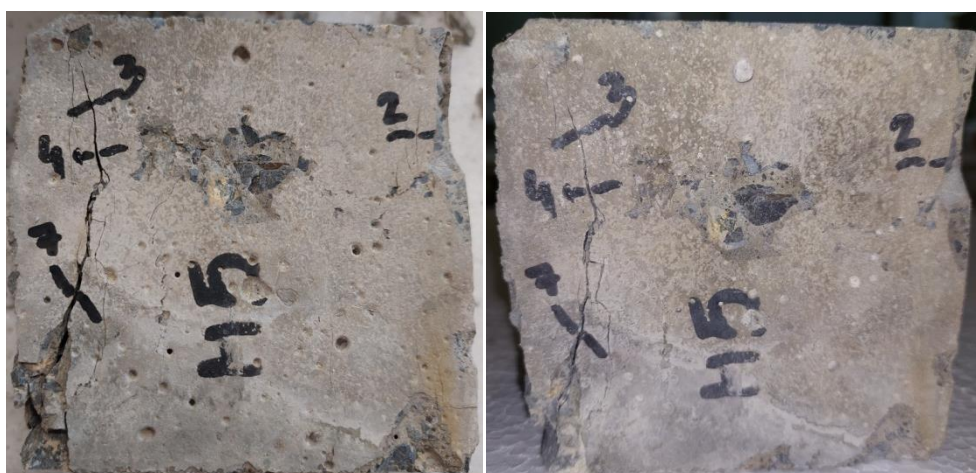
Slika 6.75. Mješavina M5 bez smrzavanja (lijevo – prije samocijeljenja, desno - nakon samocijeljenja)
