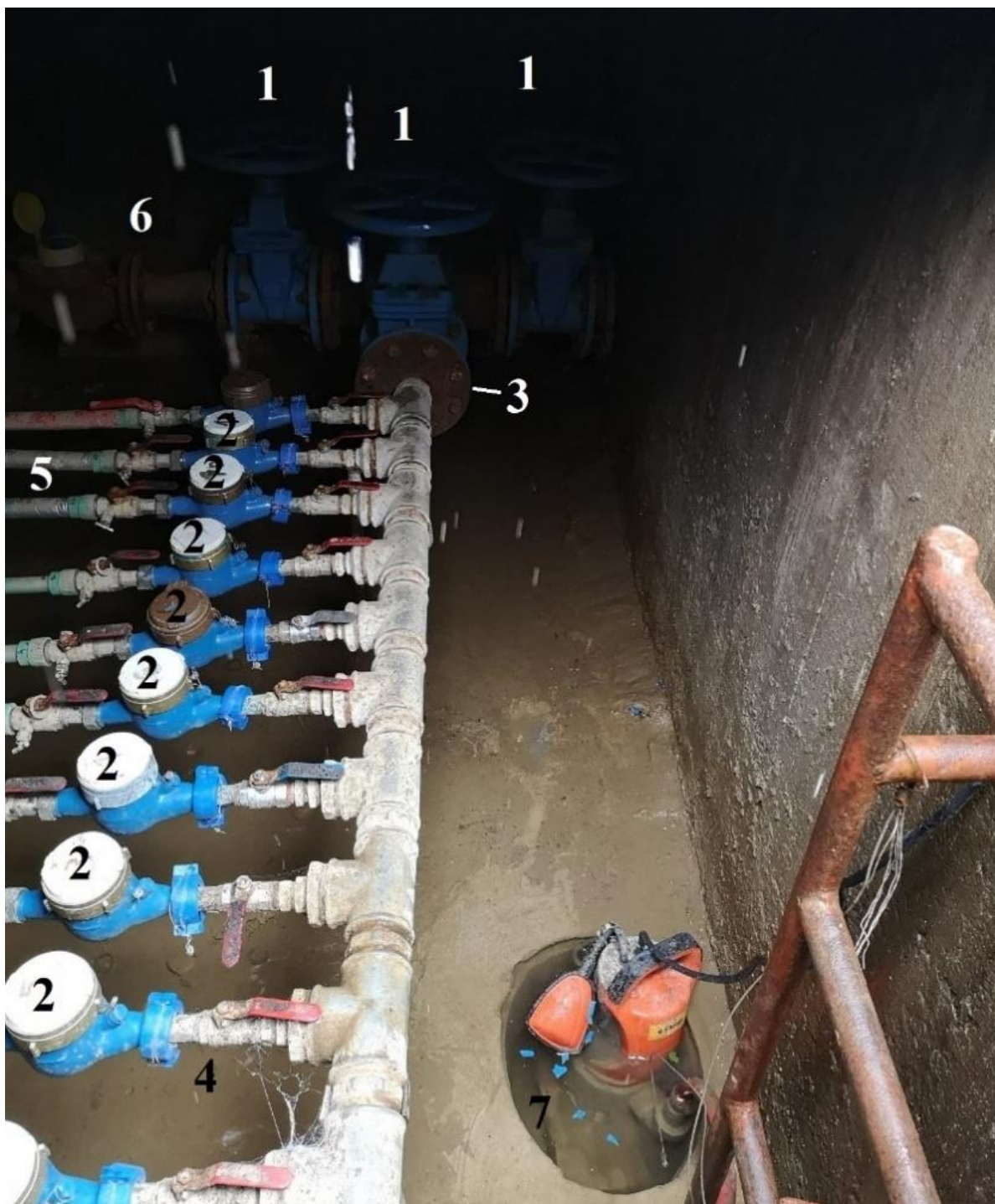
Slika 6.18 Prikaz priključnog okna u stambenoj zgradi sa zasebnim razvodom i mjeračima protoka za unutarnju hidrantsku i opskrbnu mrežu (1. EV zasun, 2. Vodomjeri, 3. Priključak za zgradu, 4. Kuglasti ventil, 5. Priključna cijev prema potrošačima DN 32, 6. Unutrašnji hidrantski vod, 7. Potopna crpka)
