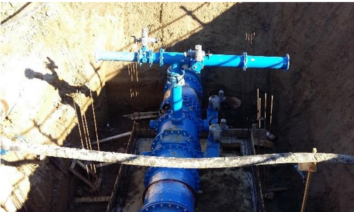
Slika 6.4 Čvorište magistralnog cjevovoda DN 800 s postavljenim fazonskim komadima i armaturama (betonirana donja ploča i pripremljena armatura za zidove okna) sa spojem na opskrbi cjevovod (DN 200). Iznad glavnog voda vidljiv je priključak (vertikalna cijev) za ogranke na vodoopskrbnoj mreži s postavljenim leptirastim zasunom na početku pojedinog ogranka [10]
