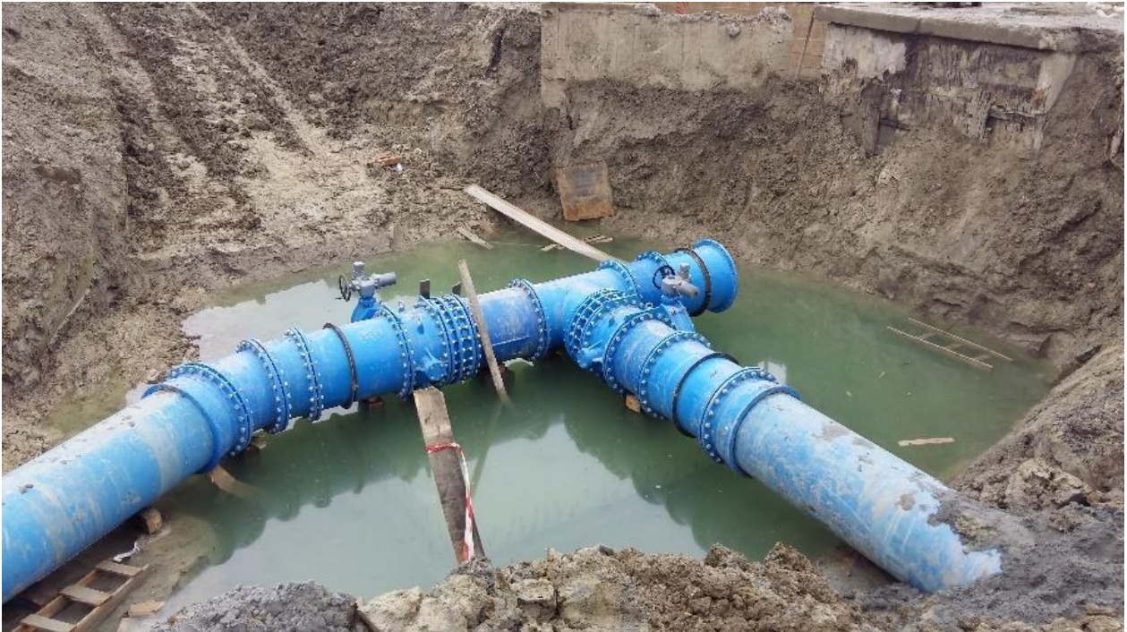
Slika 6.8 Čvorište s postavljenim fazonskim komadima i armaturama; vidljiva podzemna voda unutar građevne jame [10]
