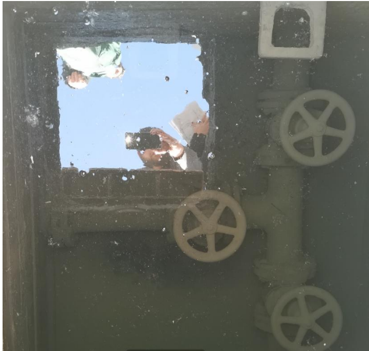
Slika 6.14 Potopljeno vodomjerno okno, u oknu se nalaze 3 EV zasuna, T komad i FF komadi - pojava vode u oknu moguća je uslijed vodopropusnosti okna ili curenja (gubitaka) vode na spojevima [11]
