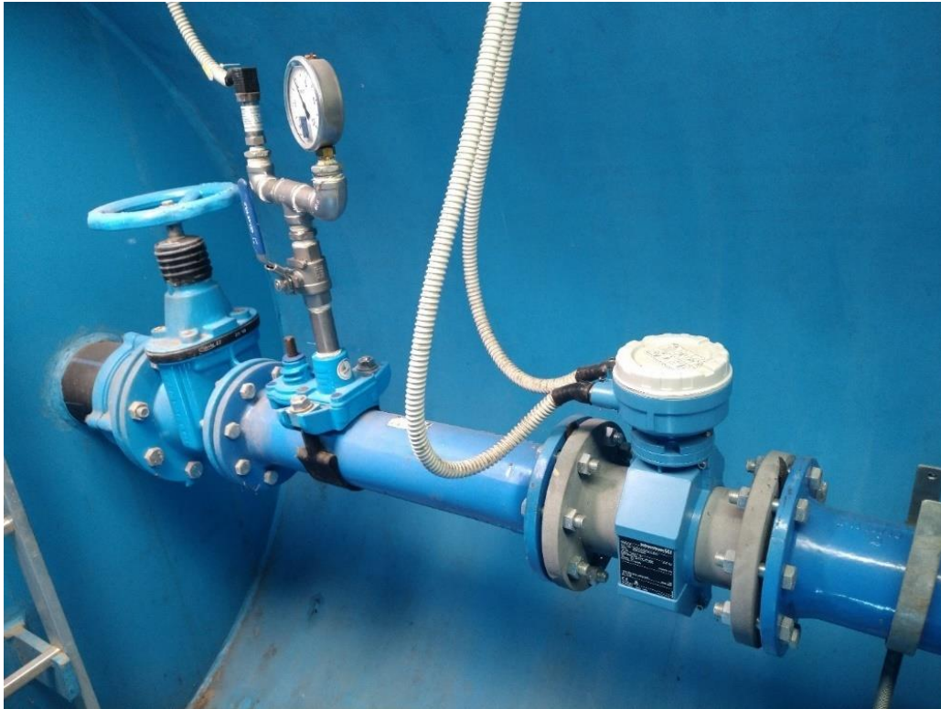
Slika 6.16 Unutrašnjost PEHD okna u koje su smješteni EV zasun mjerači tlaka i protoka spojeni na nadzorno upravljački sustav vodoopskrbe [11]
