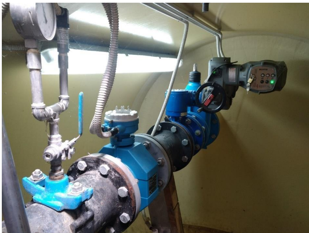
Slika 6.17 Unutrašnjost PEHD okna u koje su smješteni mjerači tlaka i protoka spojeni na nadzorno upravljački sustav vodoopskrbe, okno se nalazi neposredno uz izvorište vode [11]
