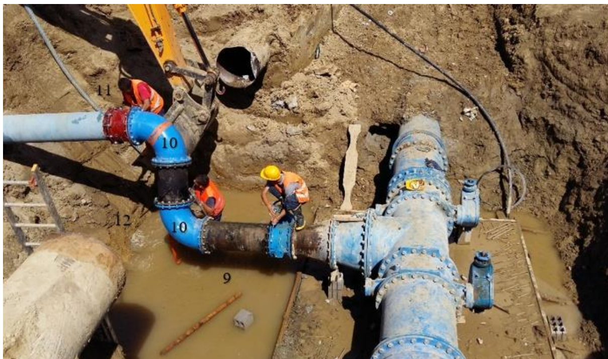
Slika 6.5 Čvorište magistralnog cjevovoda DN 800 na kojem se vrši spajanje novog cjevovoda na postojeći cjevovod DN 400
