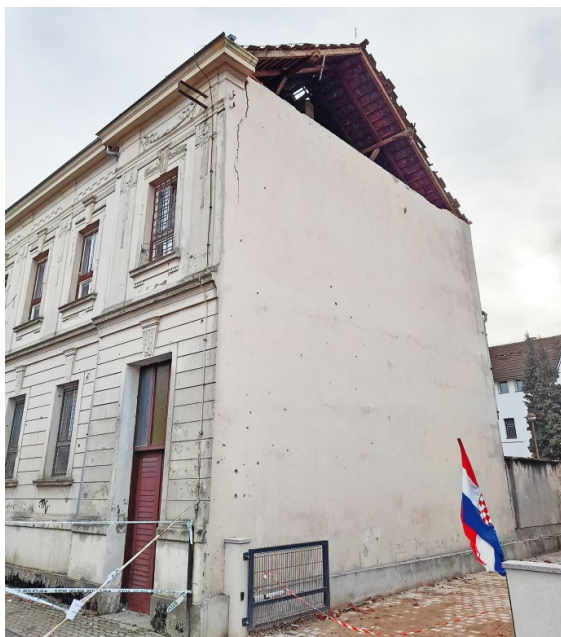
Bild 9 Beispiel für Versagen der Giebelwände infolge fehlender Rückverankerung mit dem Dachstuhl (Schadensgrad 3–4) Example of gable wall collapse due to the lack of tieback with the roof truss (damage grade 3–4)
