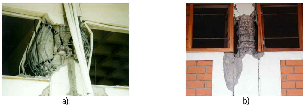
Slika 1 – Primjeri oštećenja kratkih stupova: a) detalj peterokatnice izgrađene 1997. godine prema Grčkim propisima za proračun konstrukcija otpornih na potres [1]; b) spone O10 na razmaku od 10 cm nisu spriječile teška oštećenja na stupu nastala djelovanjem potresa [2]
