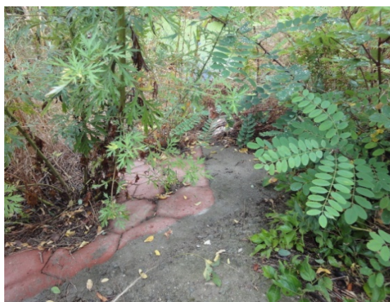
Slika 6 - Izljev u melioracijski kanal
