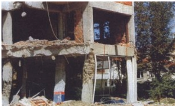
Slika 6. Oštećenja loše projektirane i loše izvedene okvirne konstrukcije
