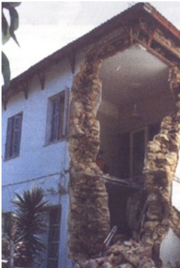
Slika 11. Rušenje kuta zidane zgrade bez horizontalnih ukruta http://www.eeri.org/Reconn/Greece1099/Greece1099-3.html
