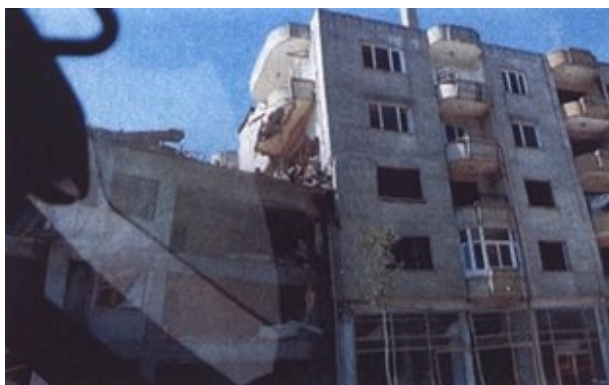
Slika 10. Oštećenje zgrade s nedovoljno širokom potresnom razdjelnicom
